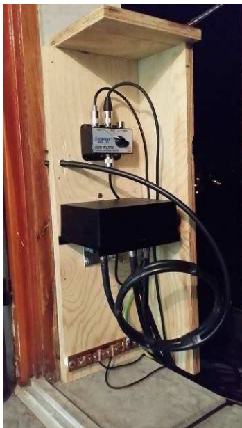
Figura 2 - Installazione esterna commutatore remoto
